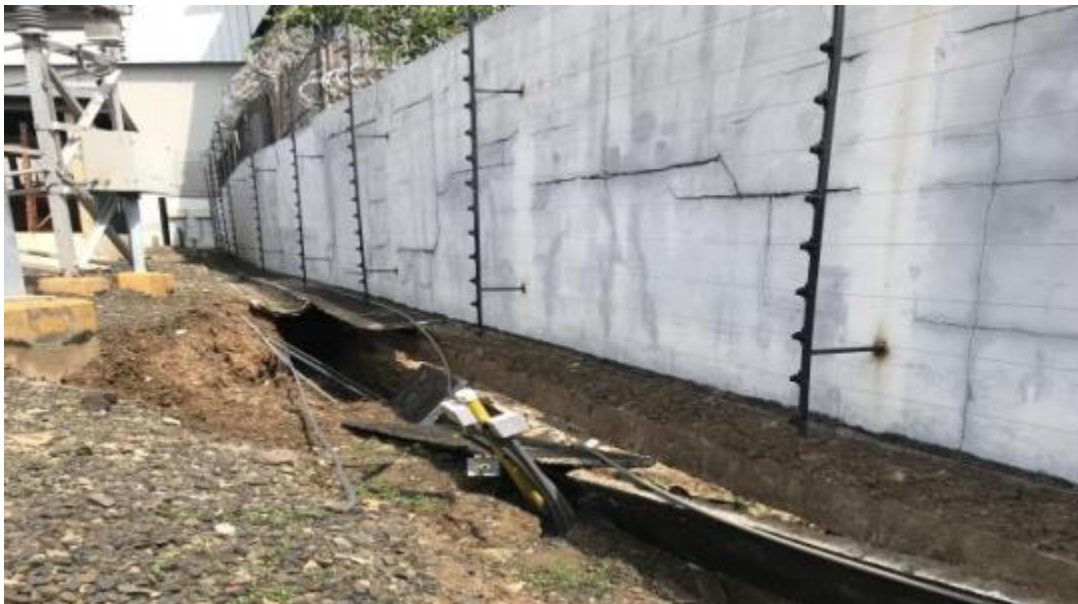
Figura 1. Muro Perimetral Socavado
