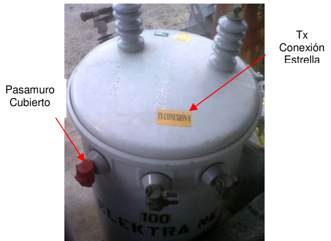
Figura N° 16. Transformador 208Y/120 V.
